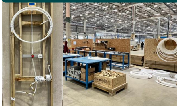
2. Estação de shaft e kit hidráulico
